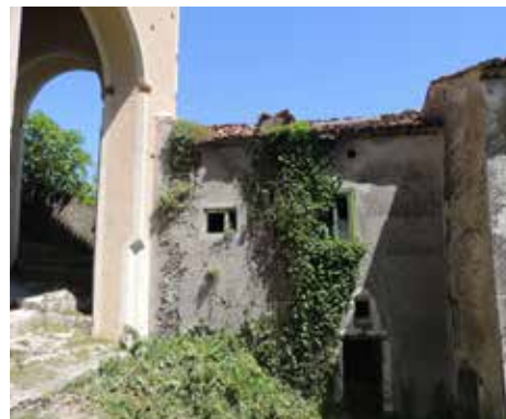
FIG. 48-49 Stato di degrado di un edificio e suo restauro con rifacimento strada pedonale.
